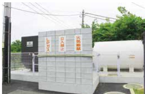
↑ 非常用発電装置
